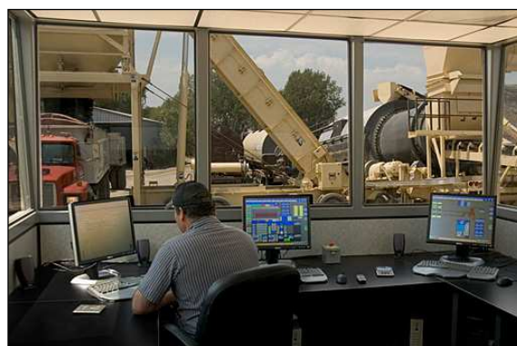
Figure 13 : Exemple de centre de contrôle (ASTECC)
